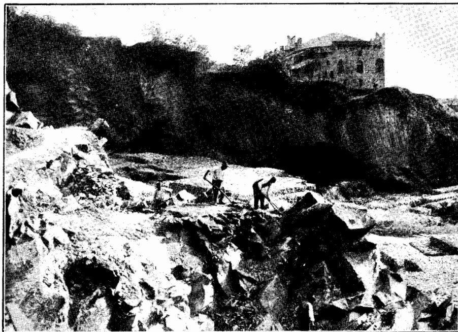
Le Cave presso Ca' Marcello che, con lo scoppio delle mine, danneggiano il bellissimo edificio.
